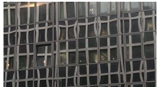
Anforderungen an Bauprodukte - hier Interferenzen (Foto: R. Spiekers)
